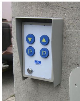
Station d'appel sans fil; aucun câblage
