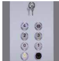
Standardschlüssel in der Kabine
