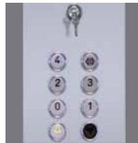
Standardschlüssel in der Kabine
