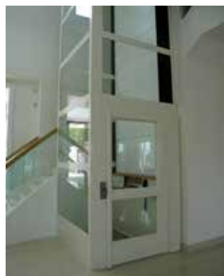
Keine Unterfahrt – eine 5 cm flache Grube ist ausreichend
